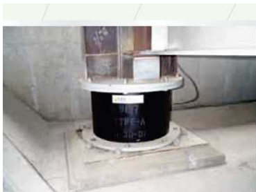
Aisladores en el Long Beach 911 Center no requiere protección contra el fuego.
