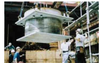
Instalación de un aislador de 1500mm de diámetro para el Condominio High City Kyosumi en Japón.
