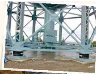
Tanque de agua mejorado en Seattle, Washington.
